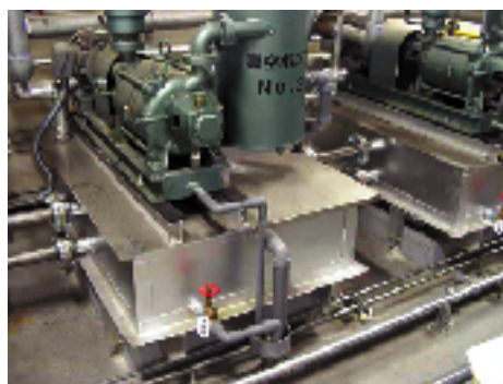
排水回収設備
